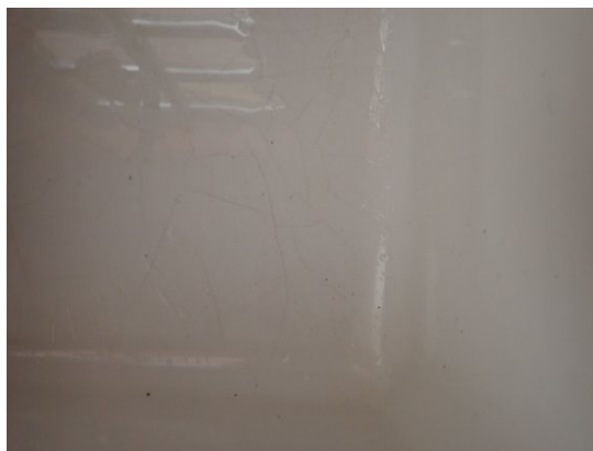
Vady a poruchy povrchů stěn a podlah
