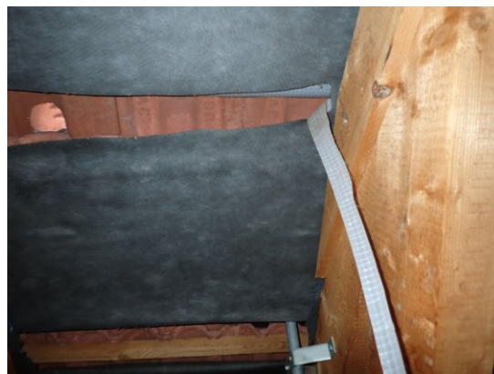
Vady střechy a střešních konstrukcí
