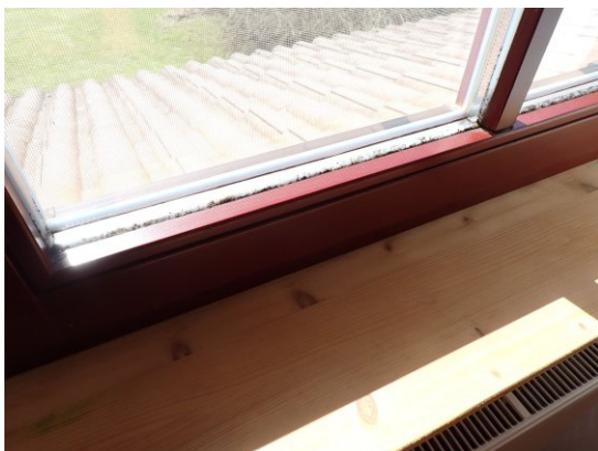
Vady a poruchy oken a dveří.
