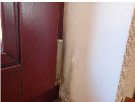
Vady a poruchy oken a dveří.
