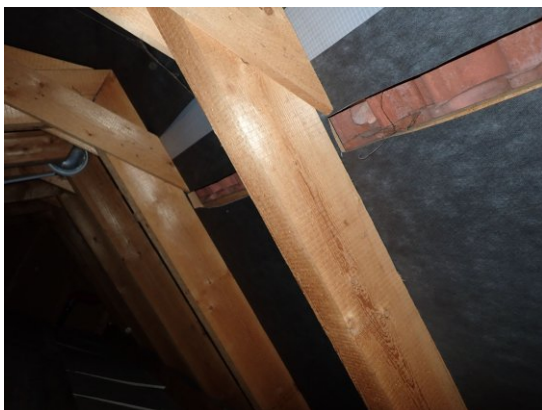
Vady střechy a střešních konstrukcí
