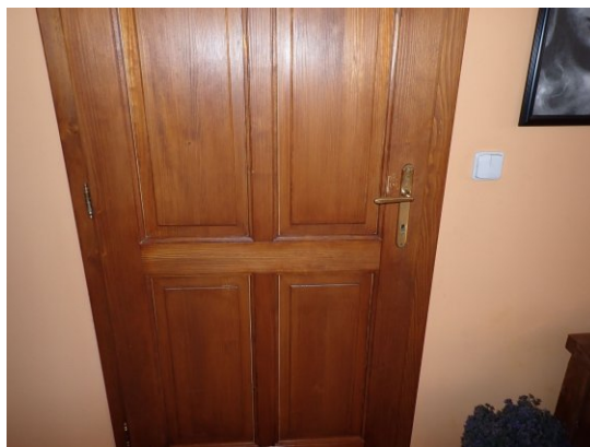
Vady a poruchy oken a dveří.
