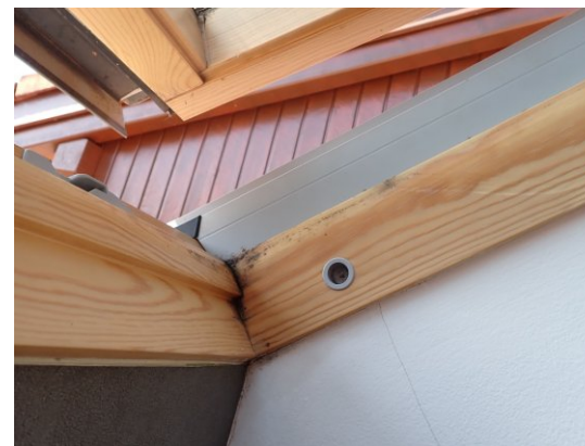
Vady a poruchy oken a dveří.
