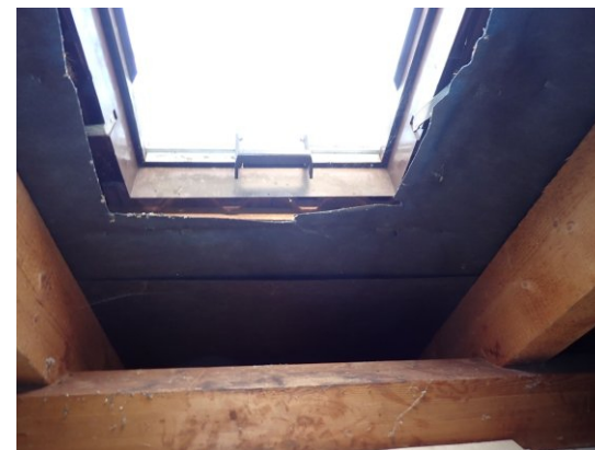
Vady střechy a střešních konstrukcí
