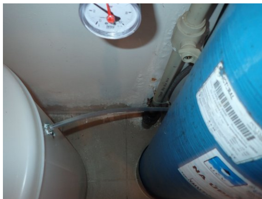
Vady a poruchy povrchů stěn a podlah
