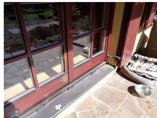
Vady a poruchy oken a dveří.
