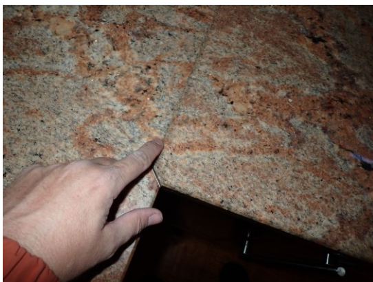
Vady a poruchy povrchů stěn a podlah
