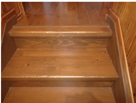
Vady a poruchy povrchů stěn a podlah
