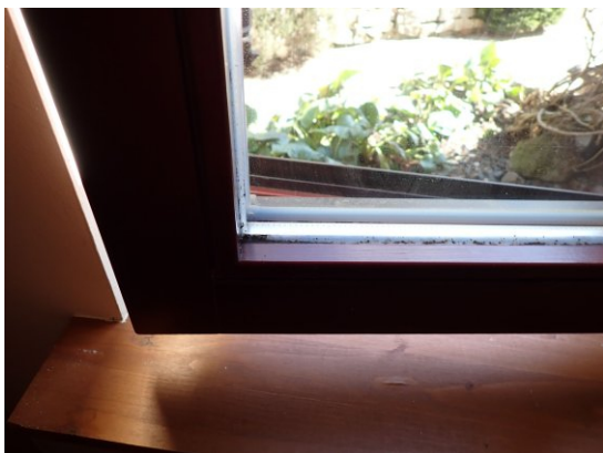
Vady a poruchy oken a dveří.
