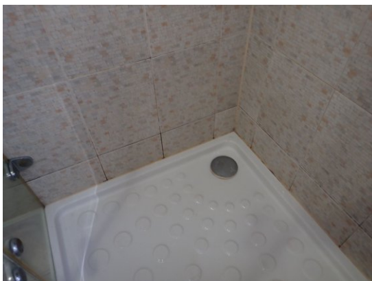
Vady a poruchy povrchů stěn a podlah
