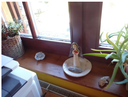
Vady a poruchy oken a dveří.
