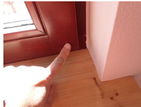
Vady a poruchy oken a dveří.
