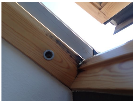
Vady a poruchy oken a dveří.
