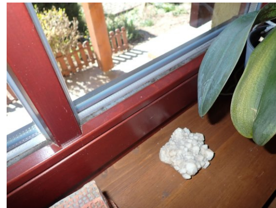
Vady a poruchy oken a dveří.
