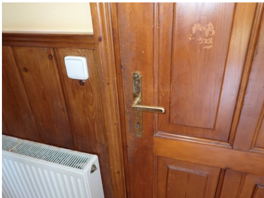
Vady a poruchy oken a dveří.
