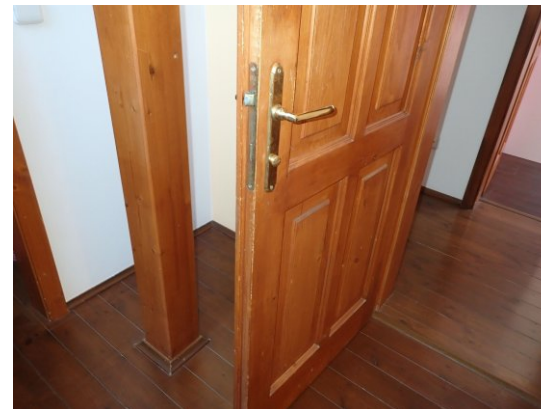
Vady a poruchy oken a dveří.
