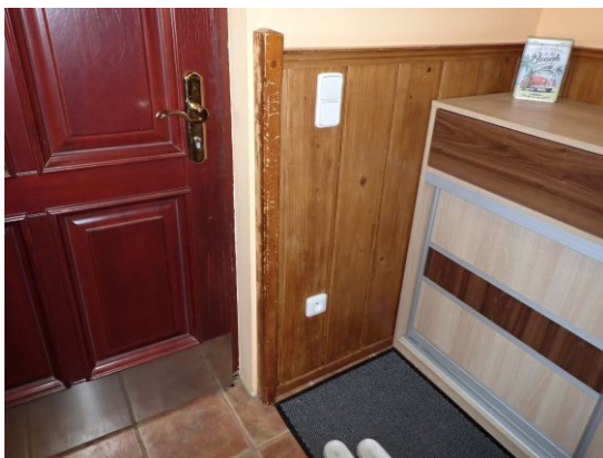
Vady a poruchy povrchů stěn a podlah
